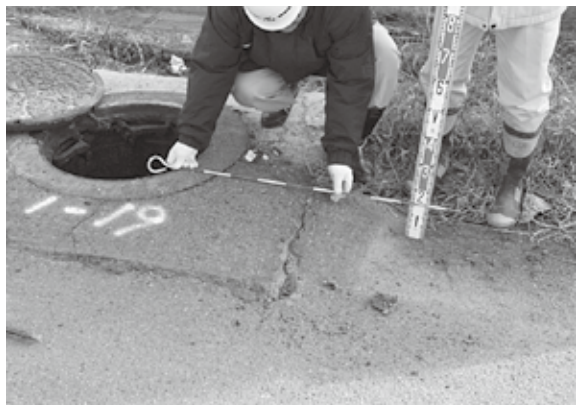
液状化現象により隆起したマンホールを調査する職員
